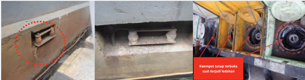
Gambar 6. Pada gambar sebelah kiri, kabel grounding dekat tanki pendam solar putus
