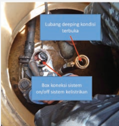
Gambar 5. Box koneksi sistem on/off kelistrikan daya pompa benam
