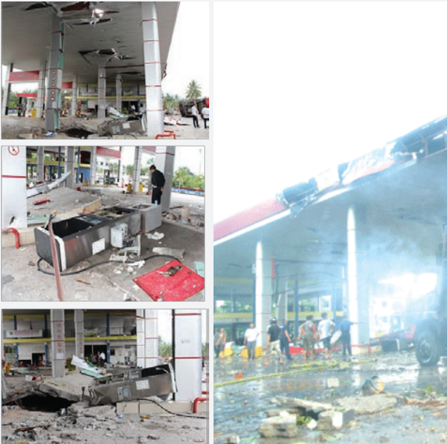
Gambar 1. Keadaan SPBU sesudah kebakaran
