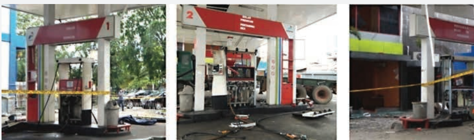
Gambar 1. Keparahan ledakan dispenser 1,2 dan 3
