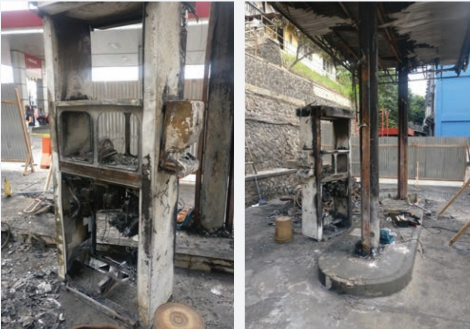
Gambar 3. Keadaan mesin dispenser setelah terjadinya kebakaran
