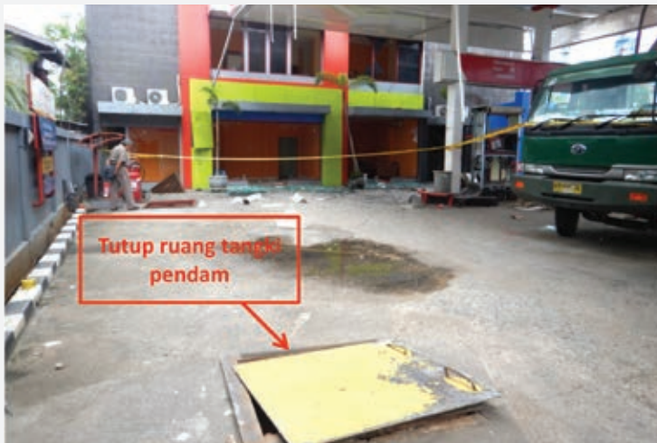
Gambar 4. Tutup ruang tanki pendam di lintasan kendaraan
