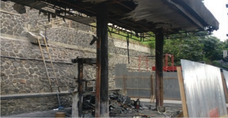
Gambar 1. Keadaan Shelter sepeda motor sesudah kebakaran
