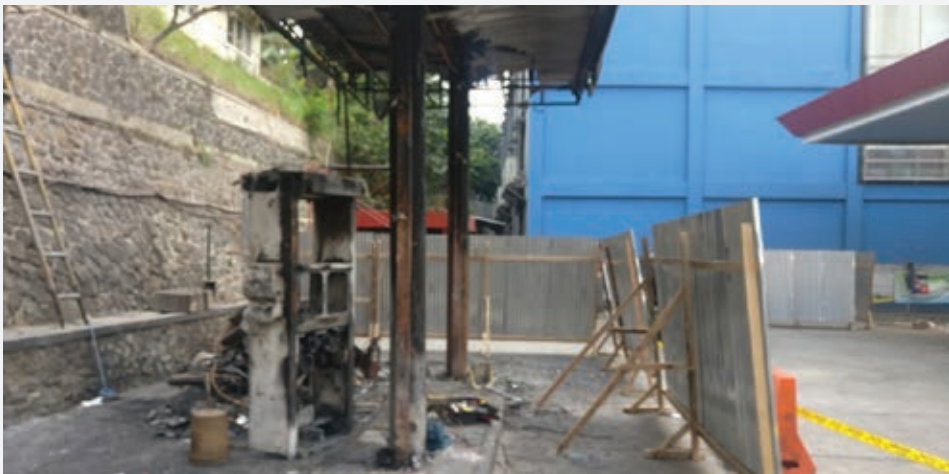
Gambar 2. Keadaan Shelter sepeda motor sesudah kebakaran
